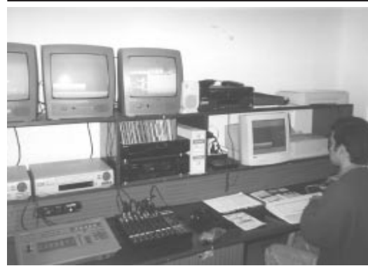
SALA DE CONTROL DE CANAL 4 TELEVISIÓN
